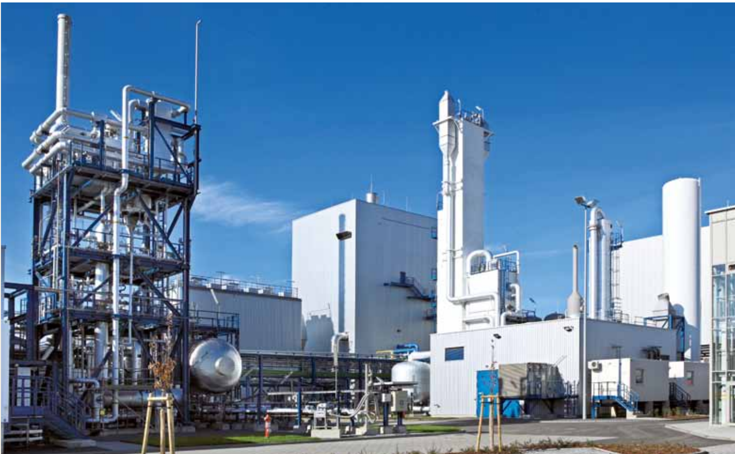
Oxyfuel-Anlage am Standort Schwarze Pumpe
