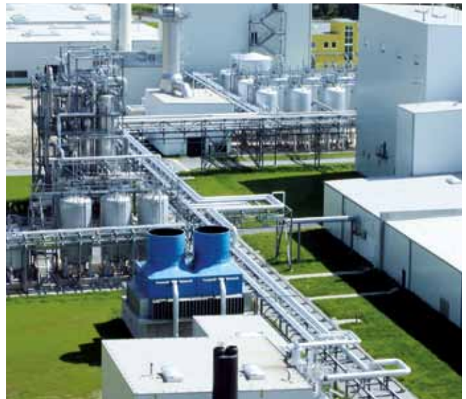
Schlüsselfertige Monoanlage zur Herstellung von Pektin in Malchin, Deutschland
