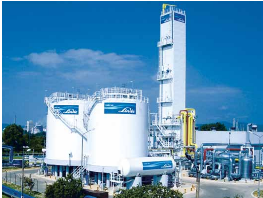
Luftzerlegungsanlage in Valcea
